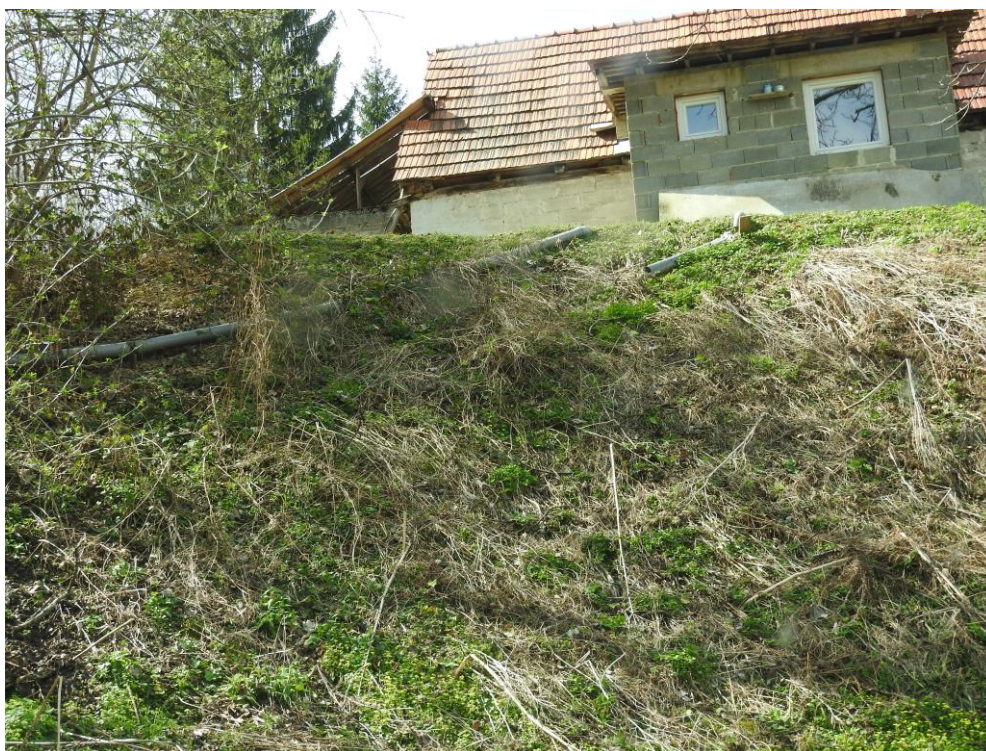
Fotografija 4-12: Direktni ispust sanitarne otpadne vode iz objekta (objekt s ID brojem 36)
