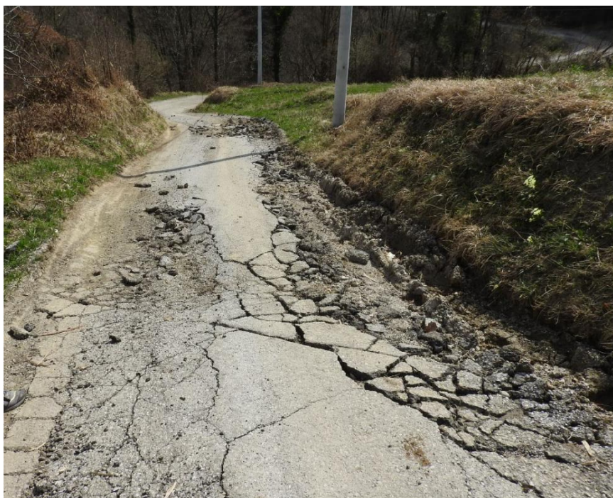
Fotografija 4-7: Oštećena nerazvrstana cesta Slapnica - Smerovišće
