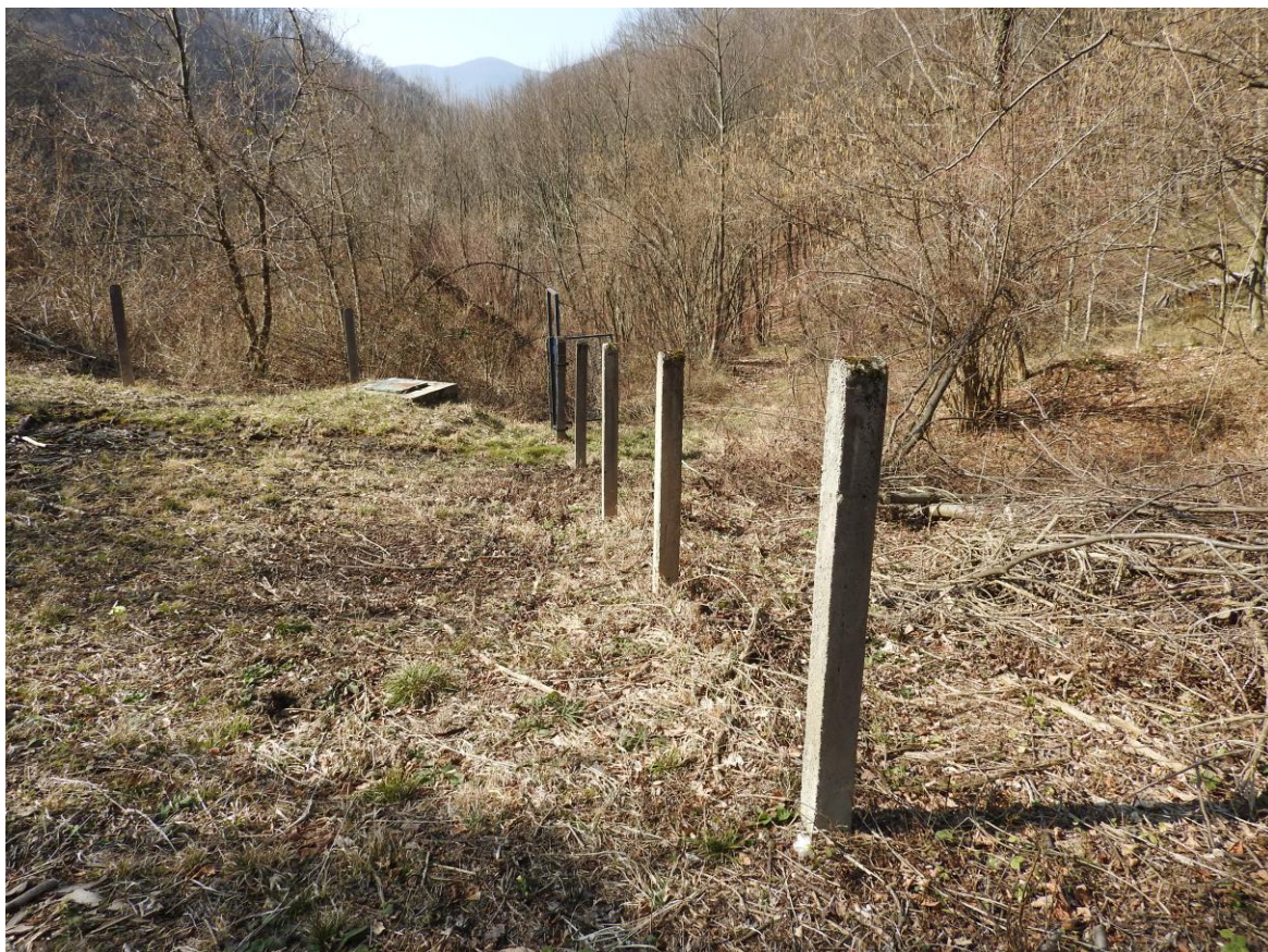
Fotografija 4-2: I. zona sanitarne zaštite (kaptaža L-6) – nedostatak žičane ograde
